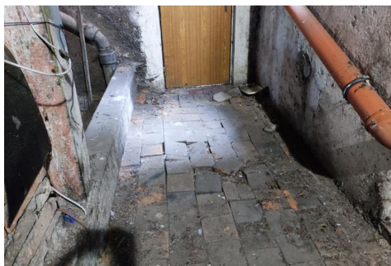
Obrázek č. 28 – Propad podlahy půdního prostoru [1]
