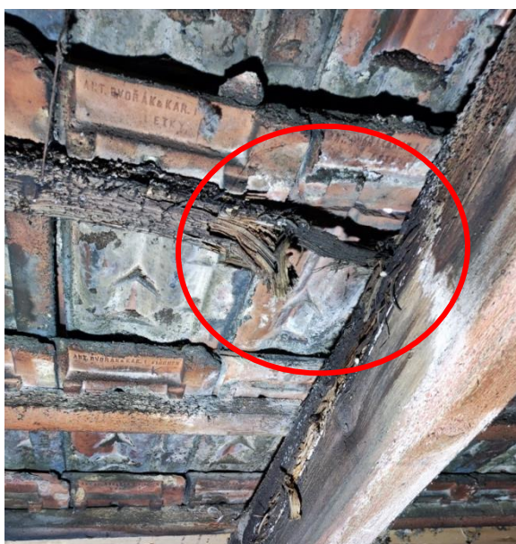
Obrázek č. 9 – Úplný rozpad prvků krovu [1]
