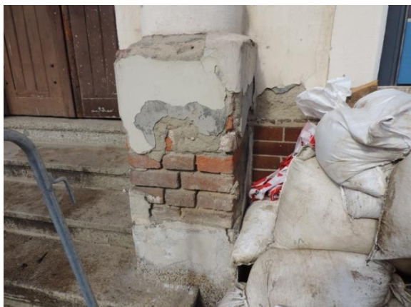
Obrázek č. 48 – Výrazné vlhkostní poruchy a odpadávání všech vrstev omítky v místě soklu [6]
