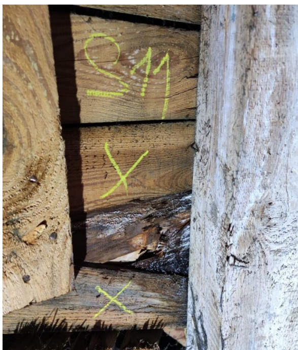
Obrázek č. 5 – Bednění napadené dřevokaznou houbou [1]
