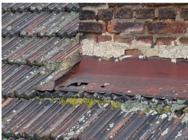
Obrázek č. 21 – Pokročilé stádium koroze lemování komínu [1]
