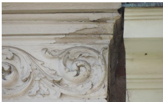
Obrázek č. 39 – Odpadávající vrchní i spodní vrstva omítky v místě napojení na okapní římsu sousedního objektu [1]
