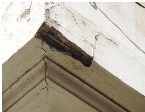
Obrázek č. 45 – Odpadávající vrchní i spodní vrstva omítky spodní hrany arkýře, s viditelným dřevěným podkladem [1]
