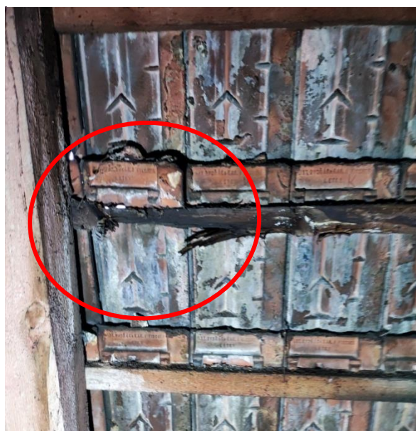
Obrázek č. 10 – Úplný rozpad prvků krovu [1]
