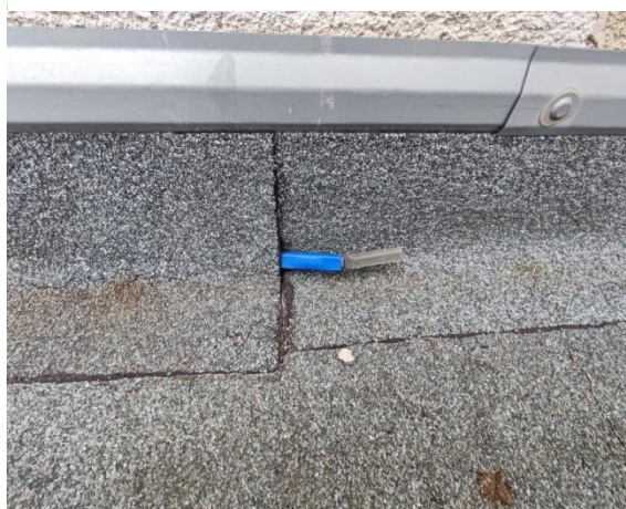
Obrázek č. 33 – Netěsnost HI v místě přechodu na svislou konstrukci [1]
