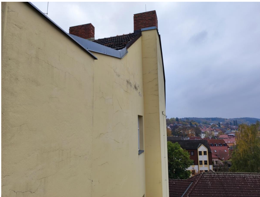
Obrázek č. 58 – Kapsovitě a spárové trhliny na západní fasádě objektu [1]
