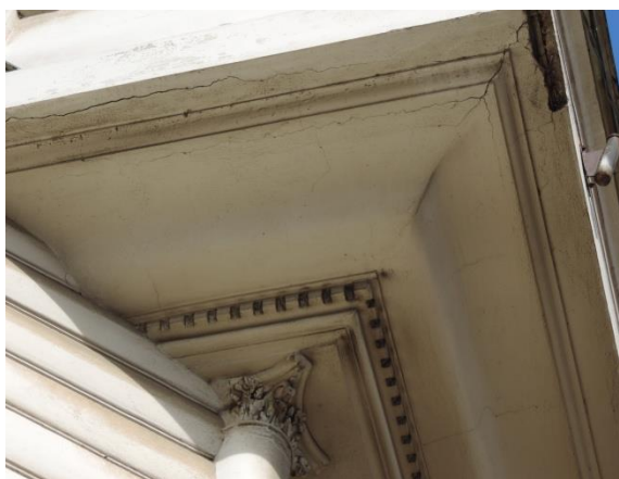
Obrázek č. 44 – Trhliny v omítce spodní hrany arkýře [1]
