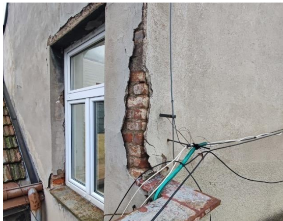
Obrázek č. 51 – Odpadávání všech vrstev omítky v místě napojení na klemp. prvky [1]
