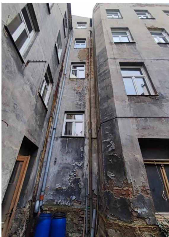
Obrázek č. 56 – Celkový pohled na poškozenou omítku dvorní fasády [1]
