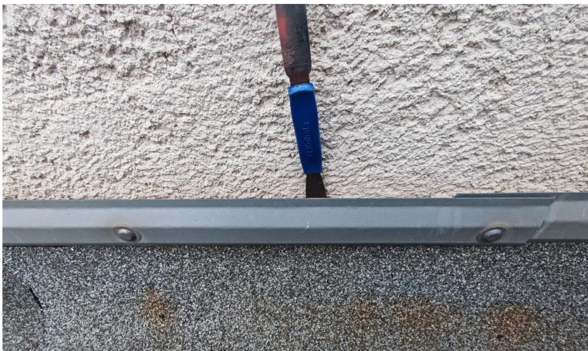
Obrázek č. 34 – Netěsnost HI v místě napojení na svislou konstrukci [1]
