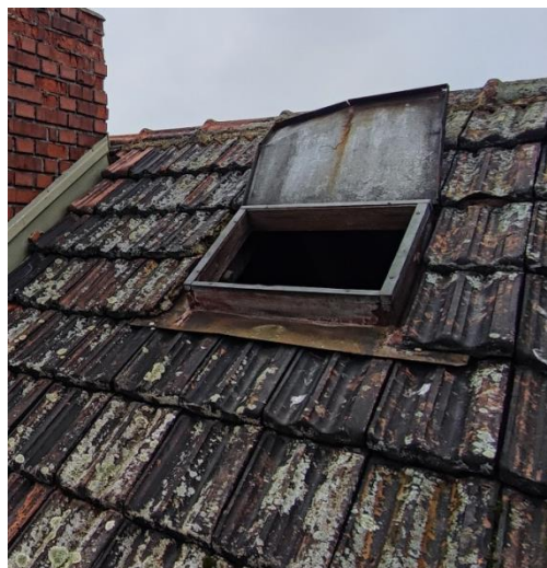
Obrázek č. 20 – Pokročilé stádium koroze oplachování střešního výlezu [1]
