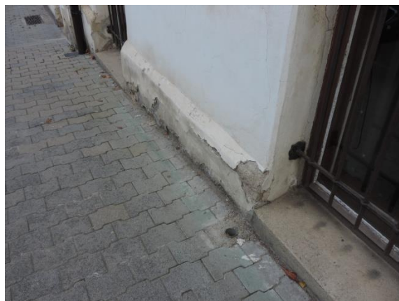
Obrázek č. 49 – Výrazné vlhkostní poruchy a odpadávání všech vrstev omítky v místě soklu [6]
