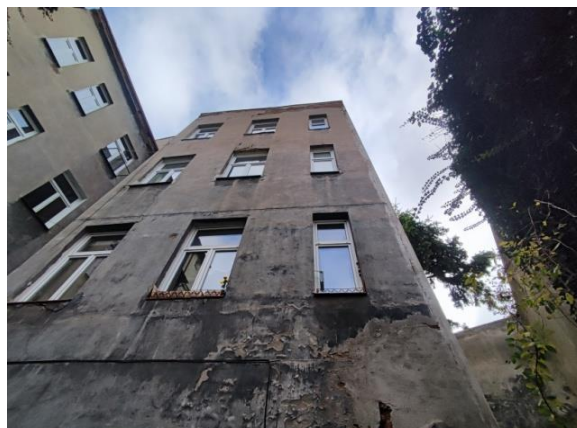
Obrázek č. 53 – Celkový pohled na poškozenou omítku dvorní fasády [1]
