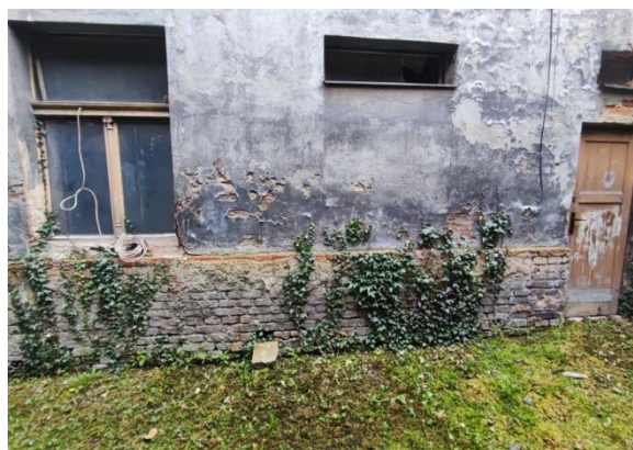
Obrázek č. 55 – Vlhkostní poruchy a odpadávání omítky v místě soklu [1]
