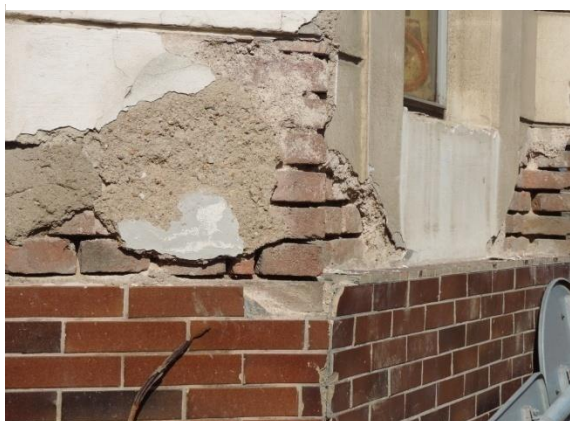
Obrázek č. 46 – Výrazné vlhkostní poruchy a odpadávání všech vrstev omítky v místě soklu [6]
