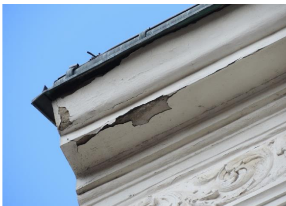
Obrázek č. 34 – Odpadávající vrchní i spodní vrstva omítky v místě okapní římsy [1]
