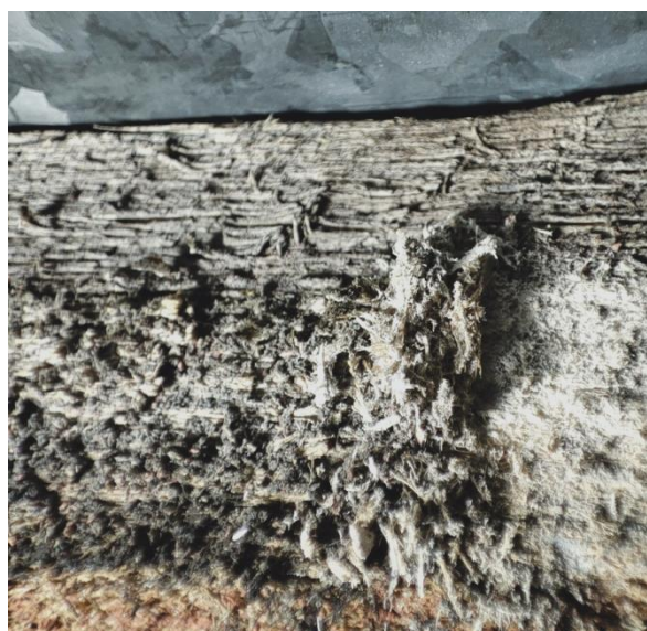
Obrázek č. 12 – Rozvláknění dřeva latě [1]
