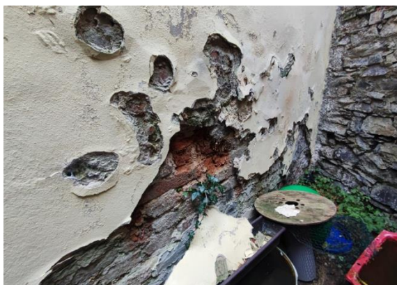
Obrázek č. 54 – Vlhkostní poruchy a odpadávání omítky v místě soklu [1]
