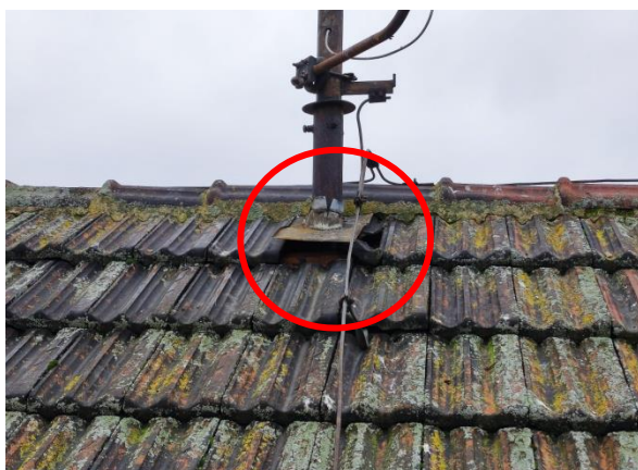
Obrázek č. 17 – Výrazná netěsnost v místě opracování anténního prostupu [1]
