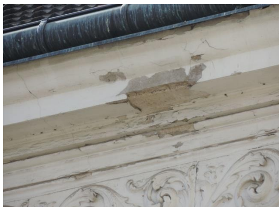
Obrázek č. 35 – Odpadávající vrchní i spodní vrstva omítky v místě okapní římsy [1]
