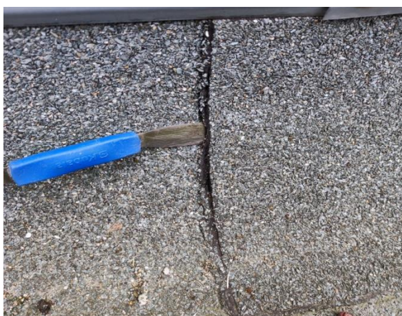
Obrázek č. 32 – Netěsnost HI v místě přechodu na svislou konstrukci [1]
