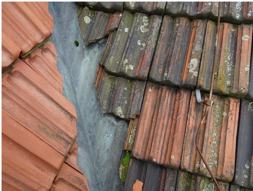
Obrázek č. 29 – Vypadlé přířezy tašek u překrytí úžlabí = pravděpodobný zdroj zatékání [1]
