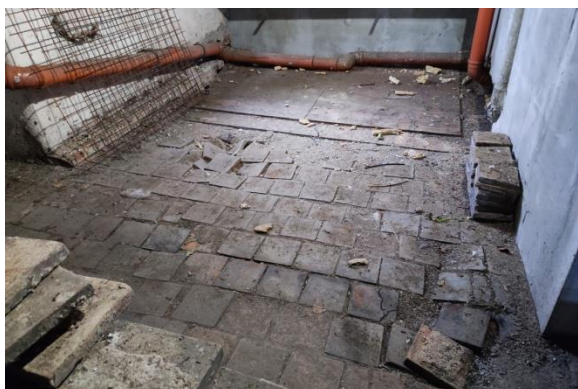
Obrázek č. 27 – Propad podlahy půdního prostoru [1]
