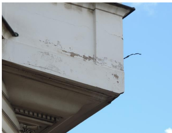
Obrázek č. 43 – Odpadávající vrchní i spodní vrstva omítky spodní hrany arkýře [1]
