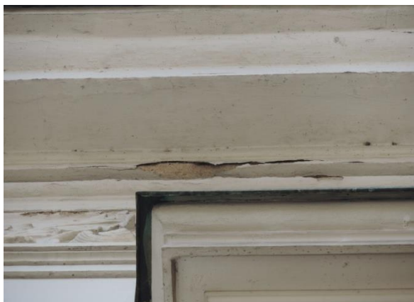
Obrázek č. 36 – Odpadávající vrchní i spodní vrstva omítky v místě okapní římsy [1]
