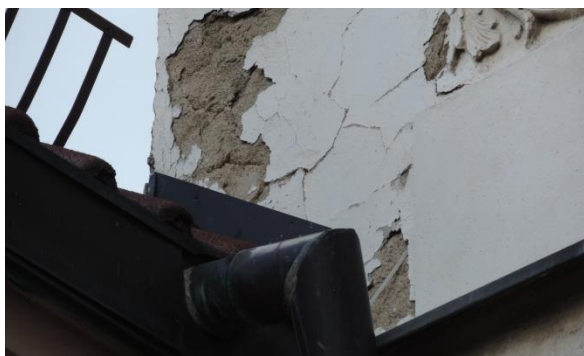
Obrázek č. 38 – Odpadávající vrchní i spodní vrstva omítky v místě napojení na střechu sousedního objektu [1]
