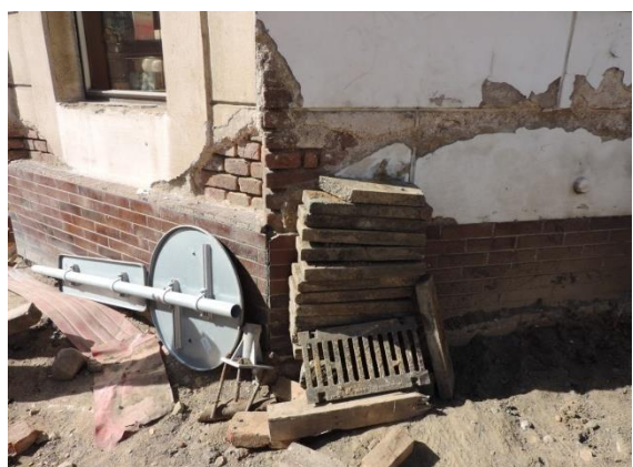
Obrázek č. 47 – Výrazné vlhkostní poruchy a odpadávání všech vrstev omítky v místě soklu [6]
