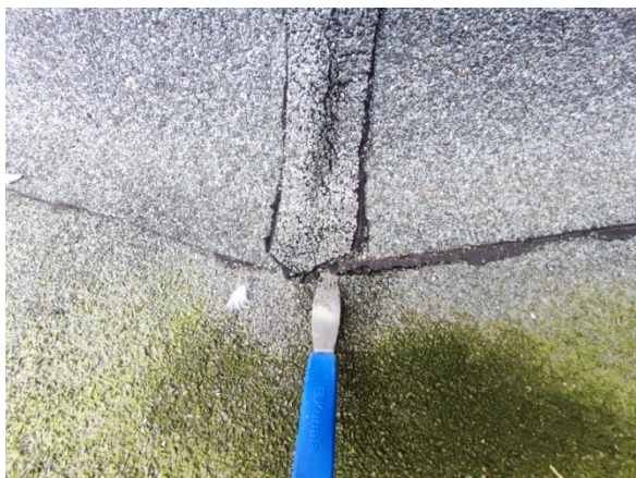
Obrázek č. 30 – Netěsnost HI v místě opracování detailů terasy [1]
