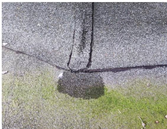
Obrázek č. 31 – Vytékající nahromaděná srážková voda [1]
