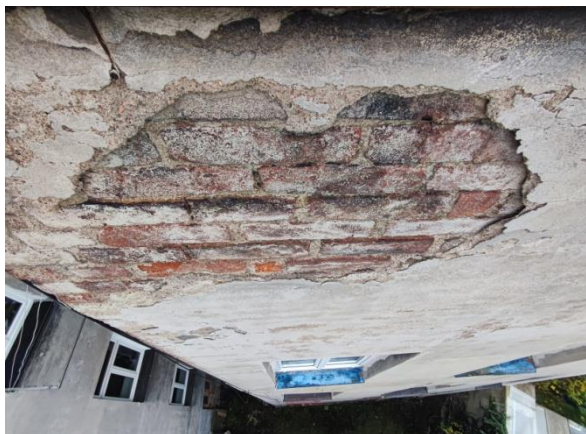
Obrázek č. 50 – Odpadávání všech vrstev omítky v místě atiky terasy [1]
