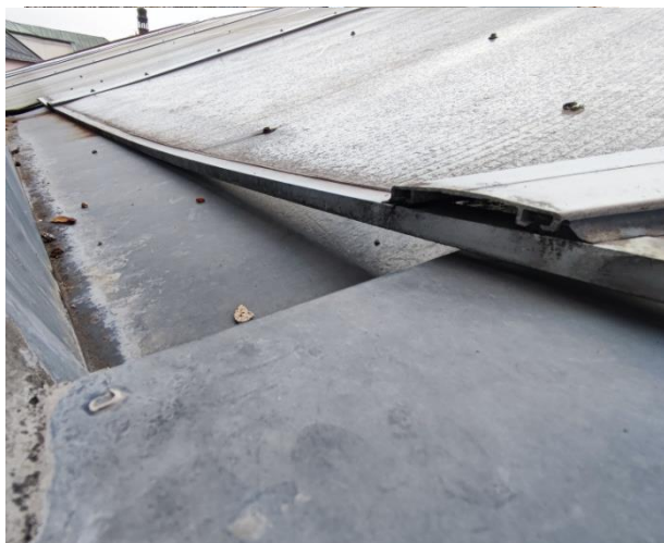
Obrázek č. 25 – Netěsnosti v opravování napojení světlíku na zbytek střechy [1]
