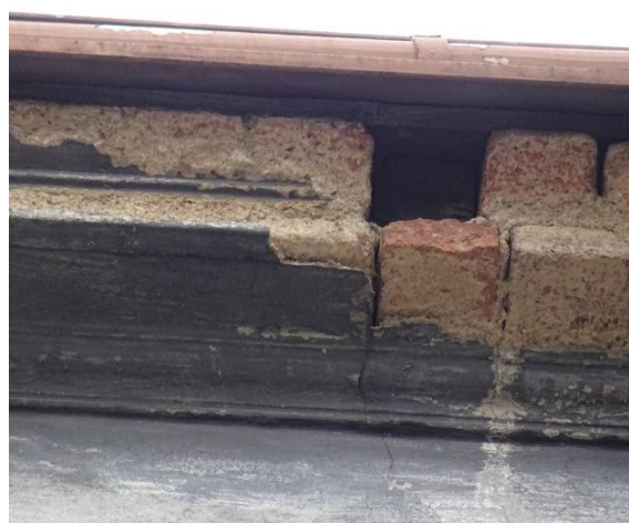
Obrázek č. 57 – Detail poškozené římsy dvorní fasády [1]
