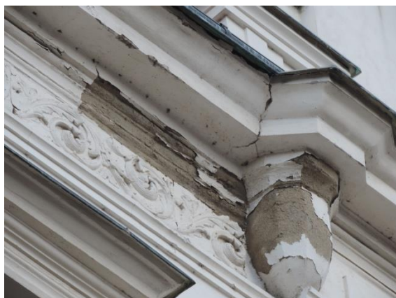
Obrázek č. 37 – Odpadávající vrchní i spodní vrstva omítky v místě okapní římsy [1]
