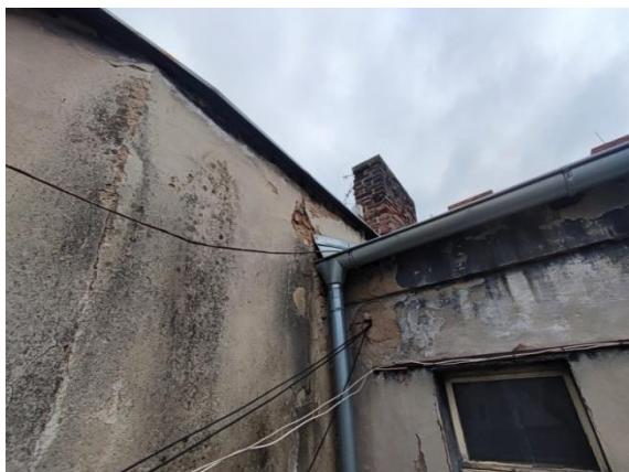
Obrázek č. 52 – Odpadávání vrstev omítky v místě napojení na střešní konstrukci [1]
