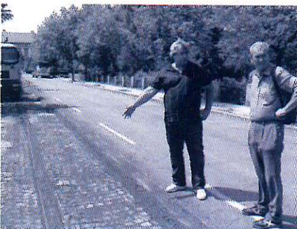
V pondělí 25. května 2009 začala závěrečná etapa výstavby odpadníkové a pěší zóny Hořejší Obora. V této souvislosti je pro automobilovou dopravu uzavřeno Dvořákové nábrží. Stavba bude podle uzavřené smlouvy s dodavatelem dokončena nejpozději do konce července 2009.
