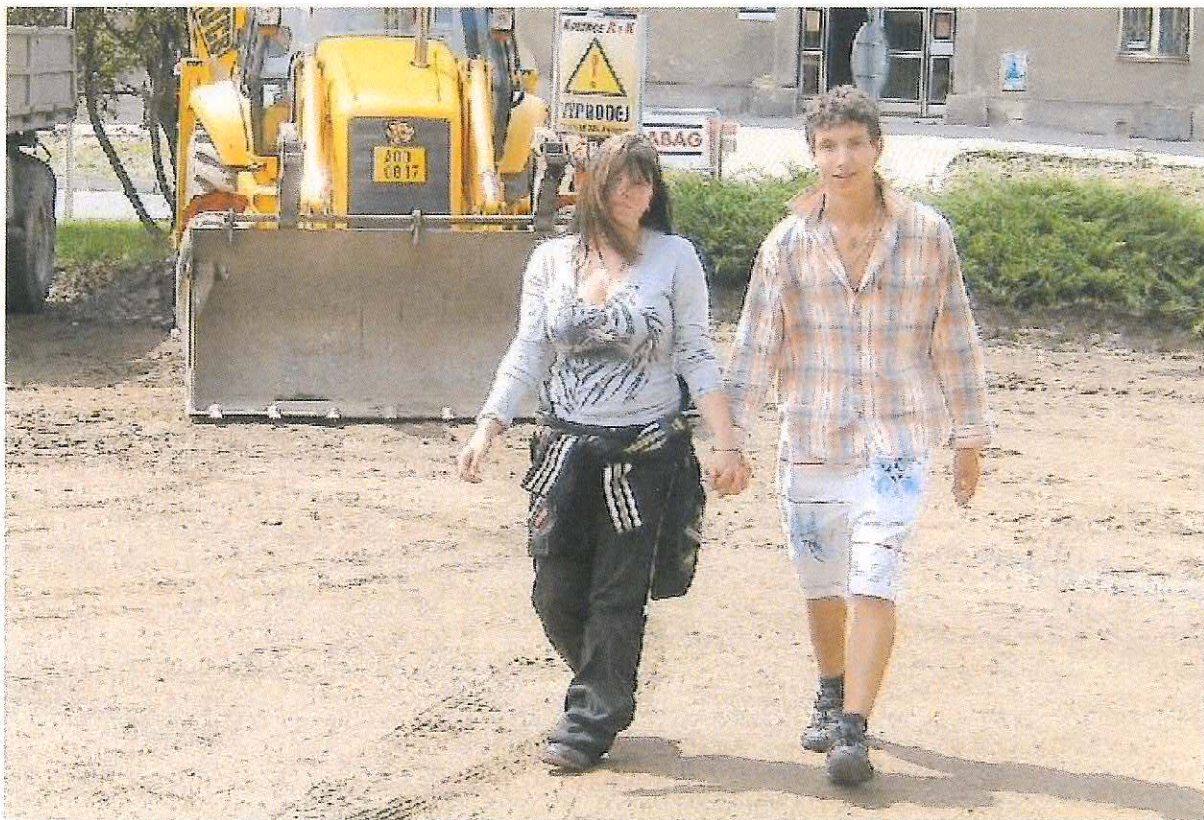
Z NÁMĚSTÍ TGM se stalo staveniště. Že se tu praší do bot lidem nevádí. Nová dlažba má být součástí první fáze rekonstrukce. Foto: Deník/Vlasta Ševr
