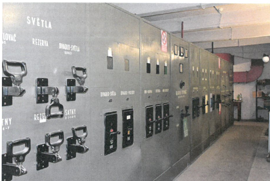
Kulturní dům, hlavní elektrorozvodna.
