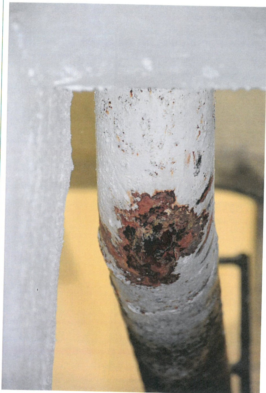
Foto ze zázemí Kulturního domu, poškozené síť.
