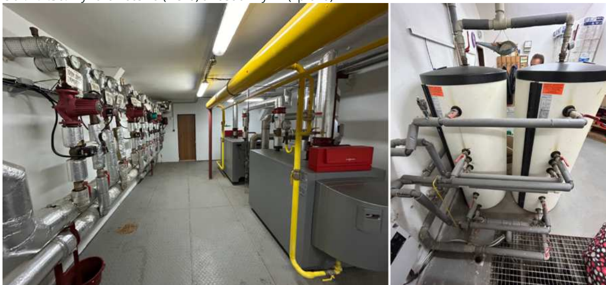
Obr. 2.7.36: Plynová kotelna (vlevo) a zásobníky TV (vpravo)
