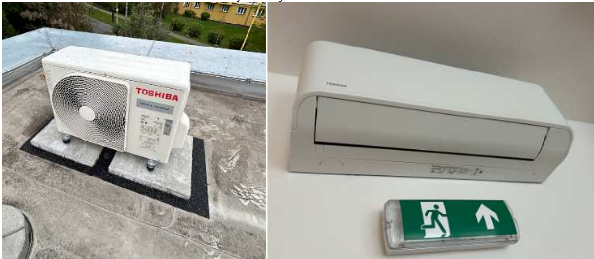
Obr. 2.7.62: Venkovní a vnitřní klimatizační jednotky
