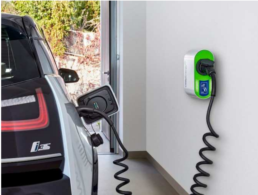
Obr. 7.7.1: Příklad nabíjecí stanice (tzv. wallbox)
