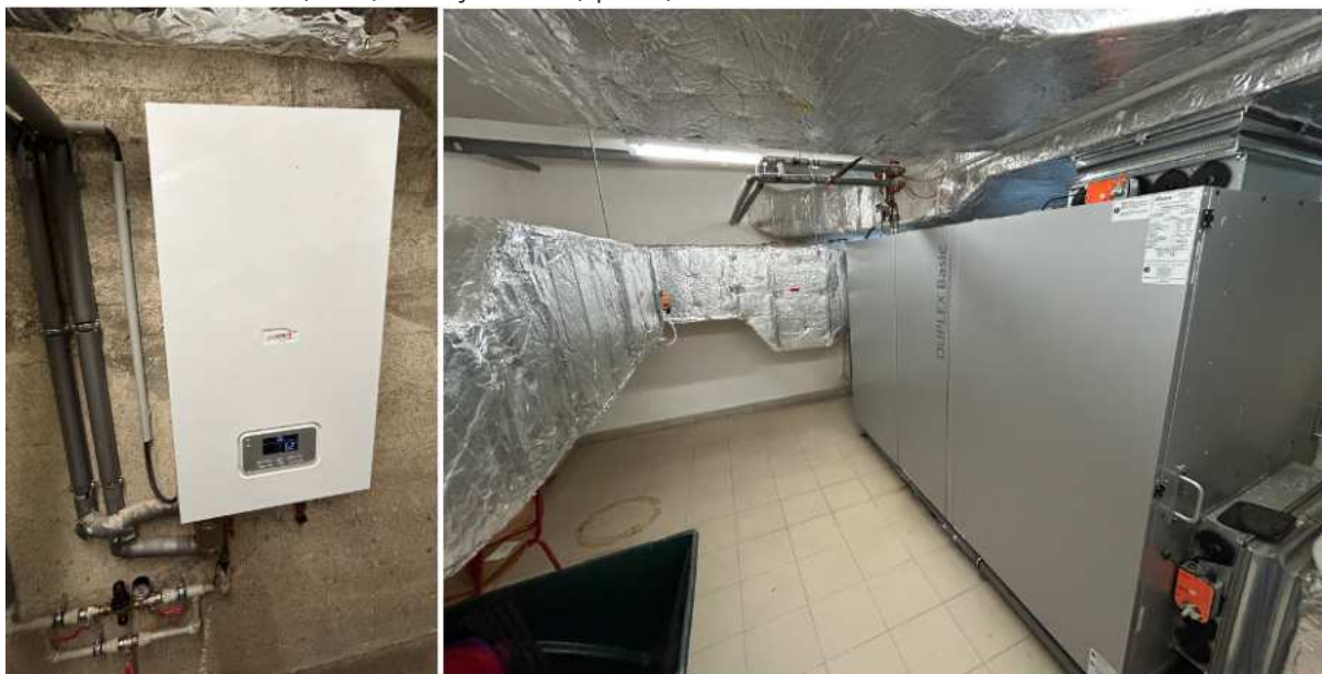
Obr. 2.7.55: Elektrokotel(vlevo) a VZT jednotka (vpravo)
