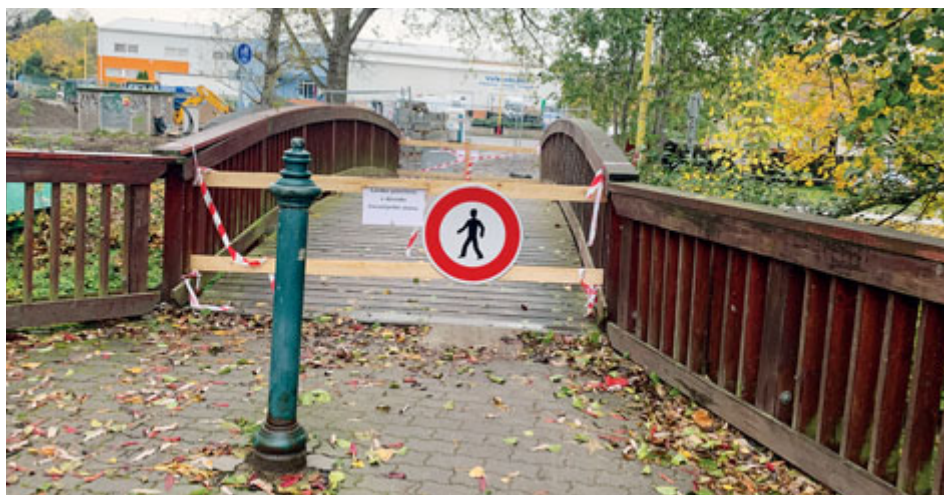
Lávka přes Příbramský potok na Flusárně musí být vyměněna, nyní je dočasně uzavřena. Foto: Eva Švehlová
